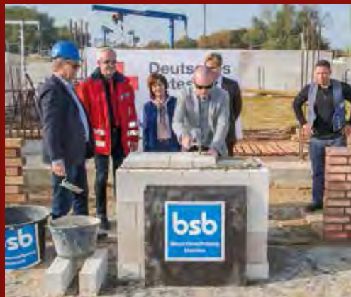
Präsident Werner Kuhn, Landesgeschäftsführer Jan-Hendrik Hartlöhner und Petra Müller, Geschäftsführerin der DRK-Pflegeeinrichtungen M-V gGmbH, (2., 3. u. 4. v.l.) ließen es sich nicht nehmen, bei der Grundsteinlegung persönlich die Maurerkelle zu schwingen.
